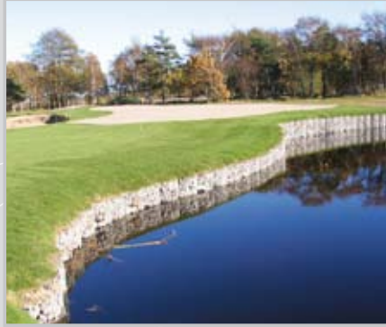
Auch für Uferbefestigungen an Seen und Wasserläufen ist FERRONDO die ideale Lösung: Erfolgreich umgesetzt auf einem Golfplatz in Schweden. (u.)
