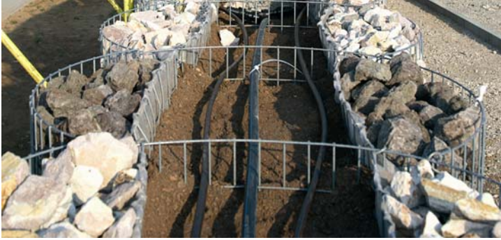
Bild 3: Das integrierte Bewässerungssystem gewährleistet eine dauerhafte Begrünung
